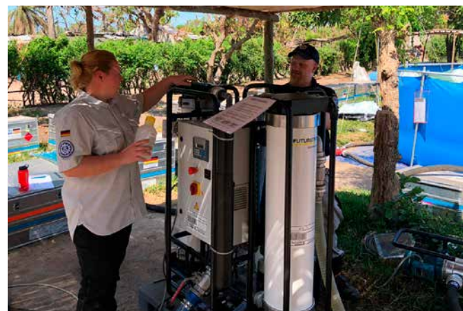
Bis die Brunnen zur Versorgung der Menschen repariert waren, setzte das THW die Trinkwasseraufbereitungsanlage „WTC 5000“ ein. Diese produziert stündlich bis zu 5.000 Liter Trinkwasser nach WHO-Standard. | Before the wells were repaired and fit to supply the population, the THW set up the drinking water treatment unit WTC 5,000, which can produce up to 5000 litres of drinking water per hour satisfying WHO standards.
